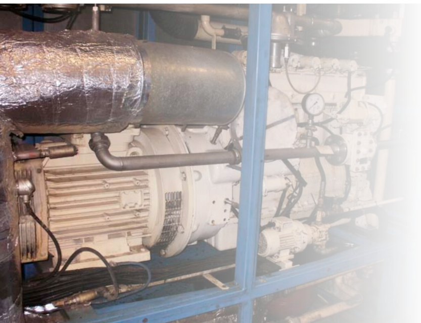
Teile der Abgasstrecke und des Motors eines BHKW.
